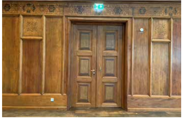
Die zweiflügelige Tür musste aktuelle Brandschutzauflagen erfüllen. Quelle: RSP GmbH
